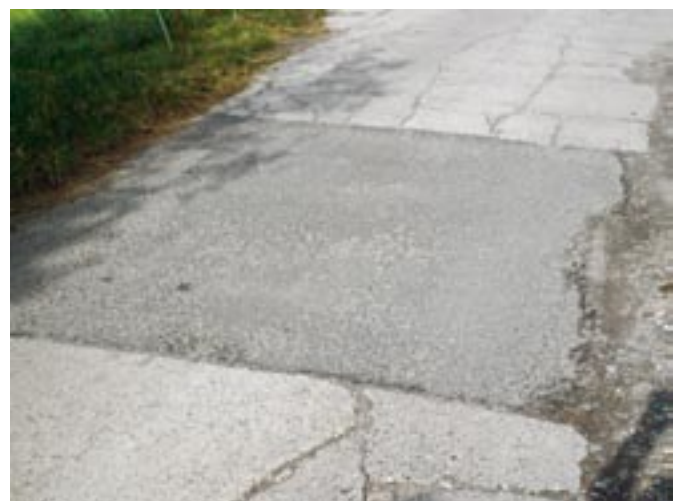
Bild 16: Für die Dauerhaftigkeit problematisch: in die Betonfläche eingefügtes Asphaltfeld
