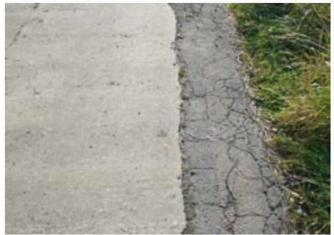
Bild 24: Unsachgemäße Verbreiterung eines Betonweges mit Asphalt
