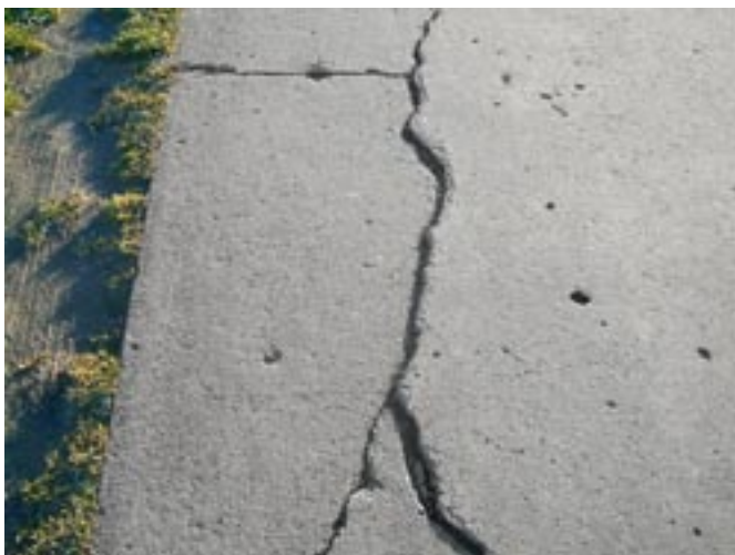
Bild 7: Risse am Plattenrand mit Absackung
