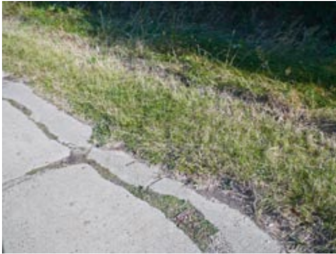
Bild 11: Risse infolge fehlender Entwässerung
