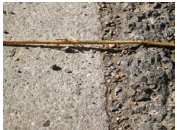
Bild 14: Überhöhung am Anschluss eines Reparaturfeldes aus Asphalt
