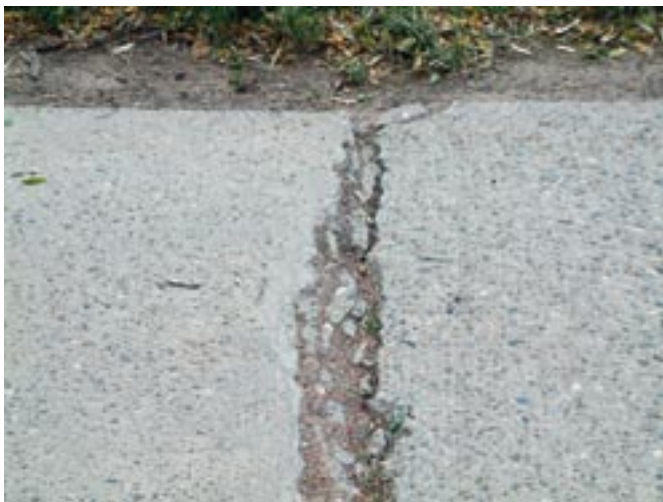
Bild 5a und b: Kantenabbruch infolge mangelhafter Verdichtung in der Fuge
