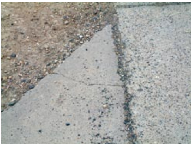
Bild 9: Riss an einem Zwickel
