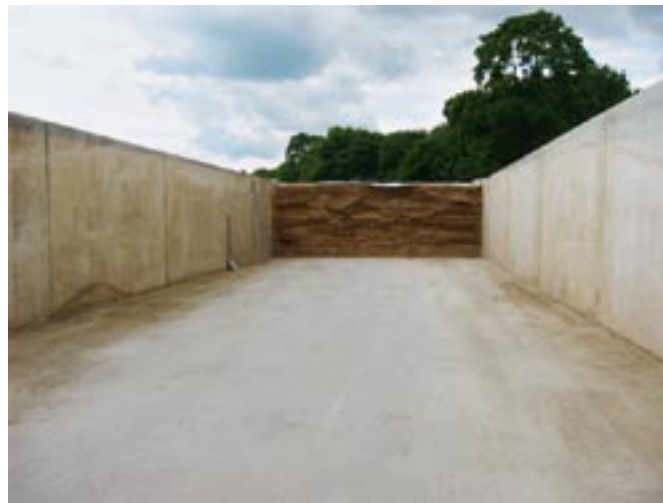
Bild 2: Gärfuttersilo mit chemischer und mechanischer Beanspruchung
